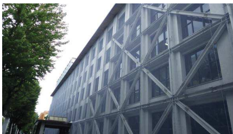
剥落防護ネット取付例
